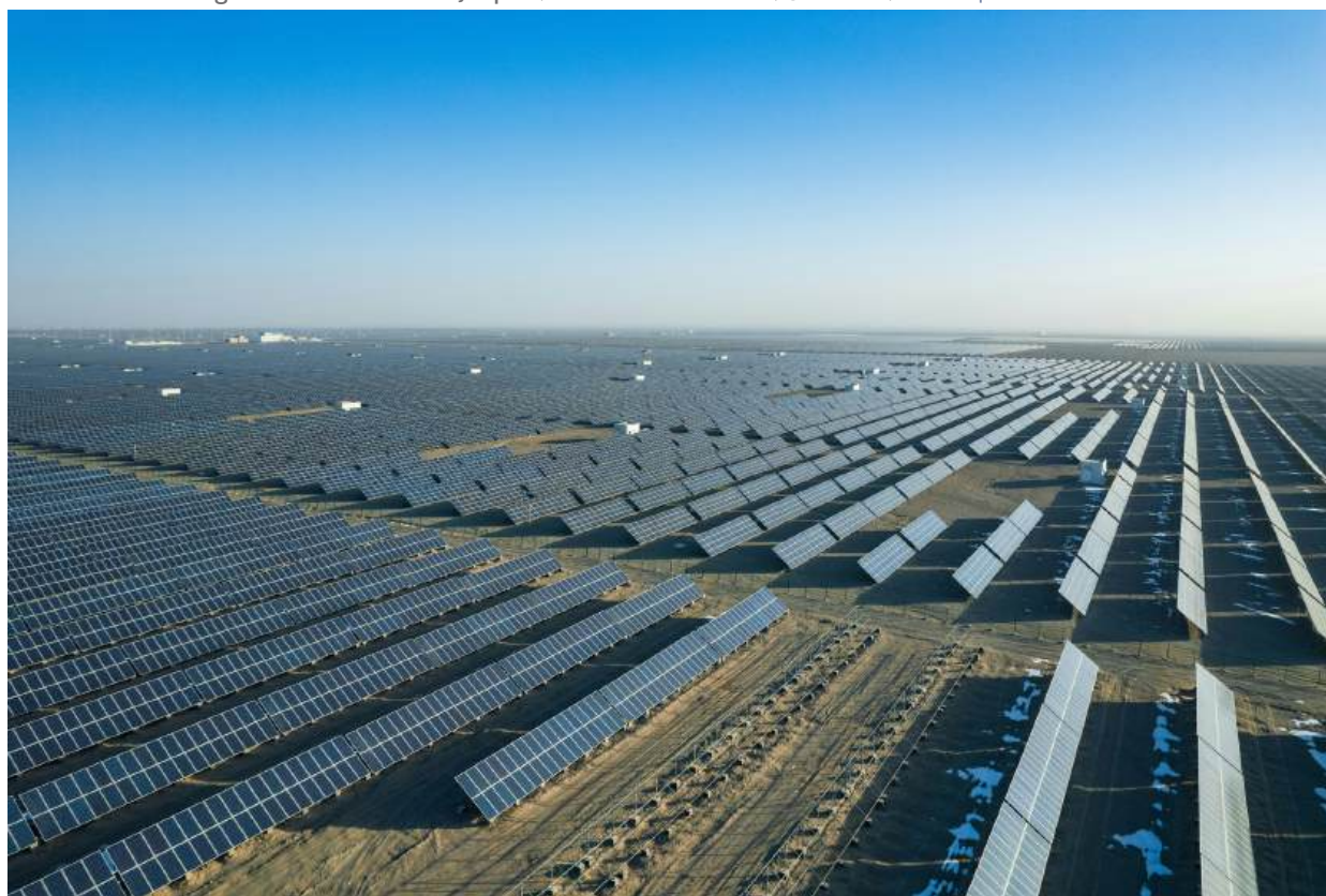
Instalación de energía solar en Ciudad de Jiuquan, China. Foto: Darmau, @darmau, en Unsplash.
